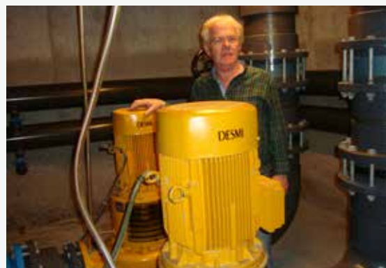
Driftsleder Bjarne Vibæk, Nyborg Svømmehal er her afbilledet i pumperummet ved siden af et par DESMI pumper.
