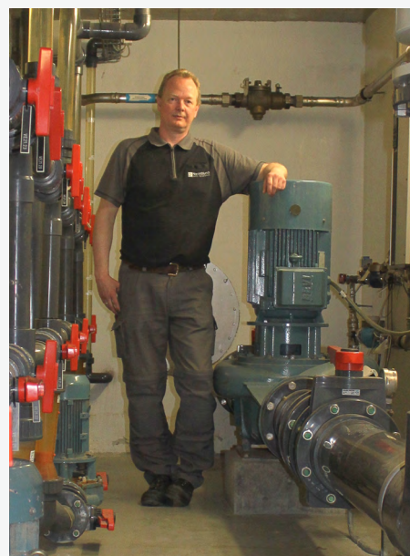
Kim Kaalund, Håndværker og ansvarlig for pumpe driften i Haraldslund er meget tilfreds med samarbejdet med DESMI
